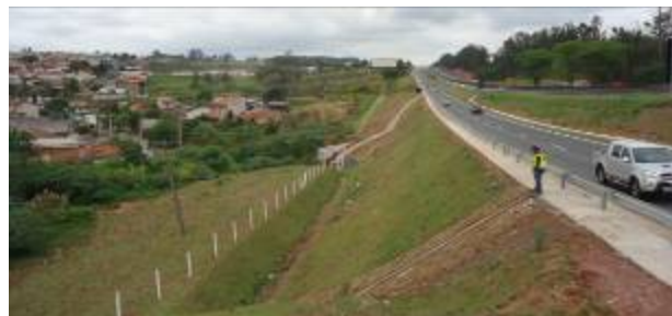
Figura 12. Situação da marginal totalmente concluída, observando-se a diferença de nível do terreno original situado abaixo da cerca no lado esquerdo da foto.
