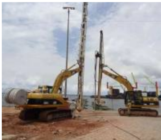
...neutralizando futuros excessos de poropressão...
