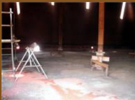
Interior do tanque com abatimento de laje radier
